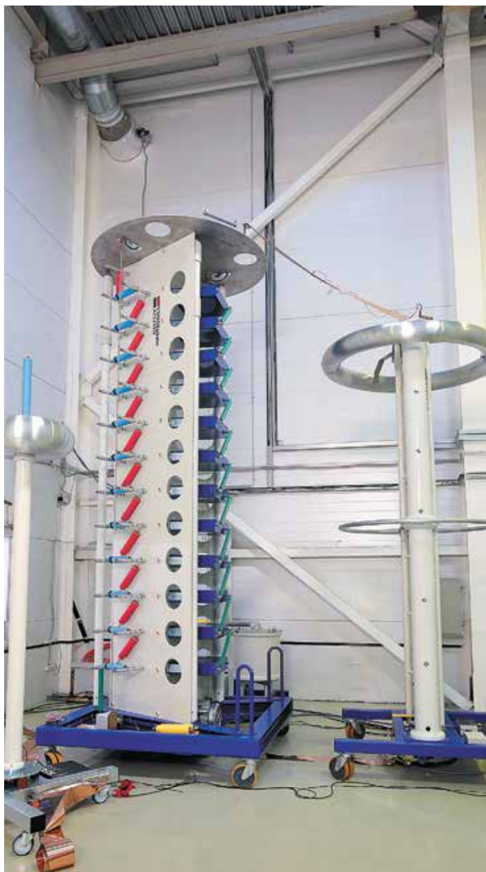
Генератор импульсного напряжения 1200 кВ, установленный в испытательном центре компании «Изолятор»
