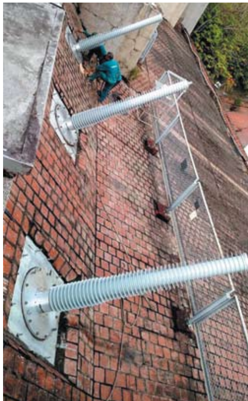
Линейные вводы «Изолятор» 220 кВ с RIP-изоляцией на ГЭС Хоабинь
