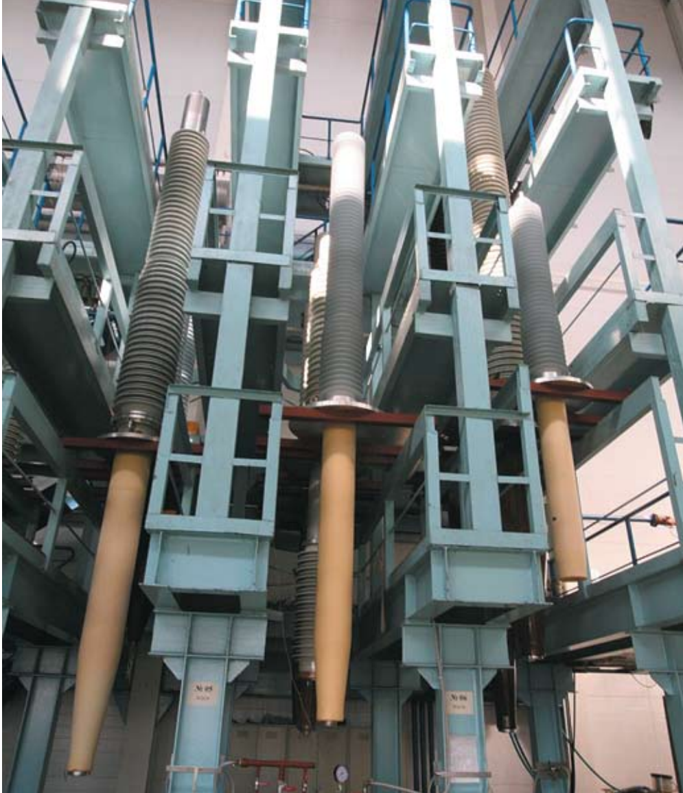
Рисунок 3. Вводы 220–500 кВ на сборочном стенде
