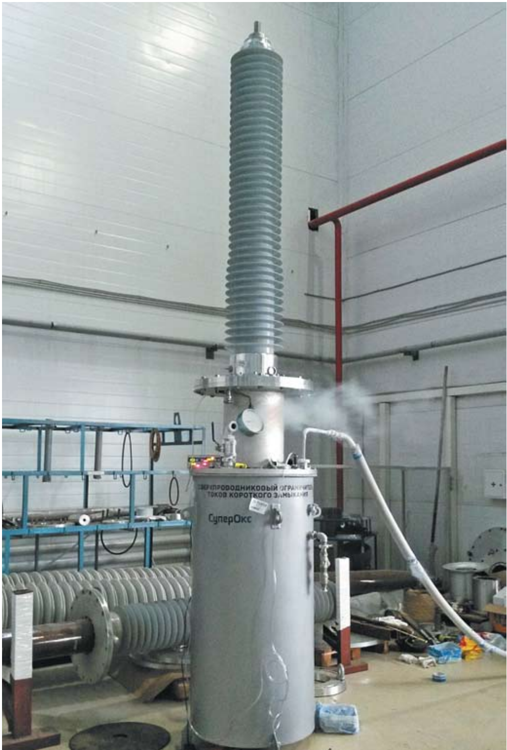
Рисунок 6. Ввод 220 кВ в криостате в процессе проведения испытаний
